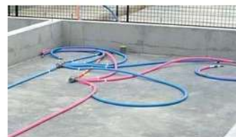
ヘッダー配管
